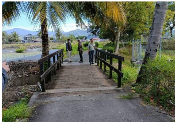
園區木棧橋木板老舊待改善(一)
