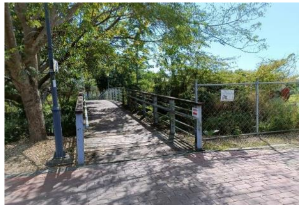
園區木棧橋木板老舊待改善(二)
