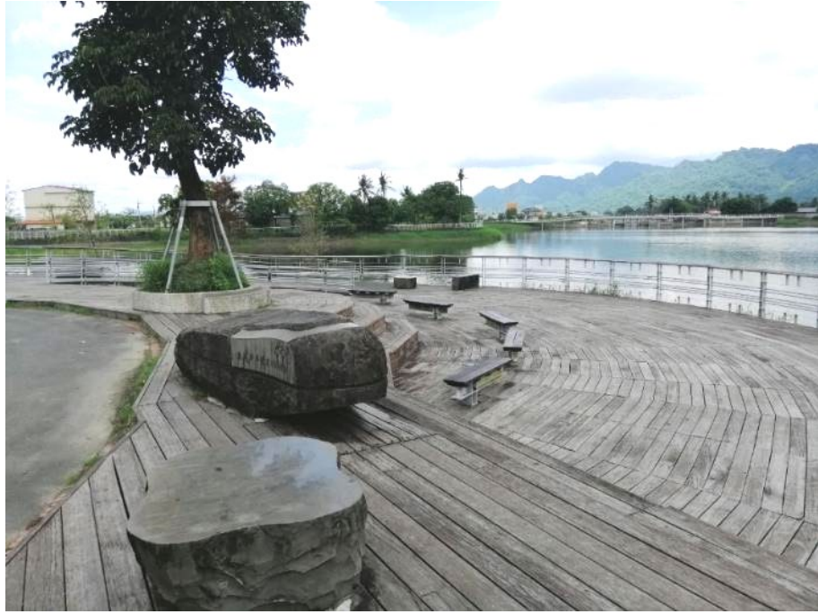
東側既有平台木板老舊待改善
