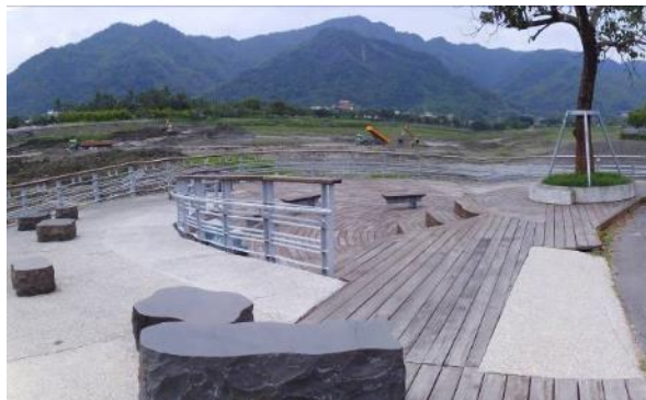
東側既有平台木板老舊待改善
