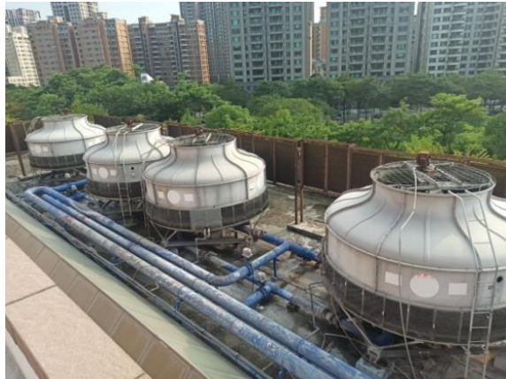
本館散熱水塔為冰水主機之輔助設備，一併更新有助於效率提升加乘效果
