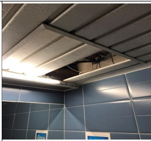
兒美館廁所天花板潮濕形成斑點及粉化
