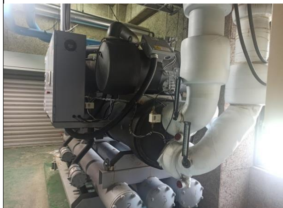
兒美館冰水主機壓縮機幾經維修，已近不堪使用
