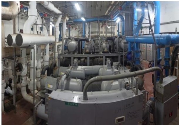
本館舊有空調冰水主機運轉效率較差且耗能
