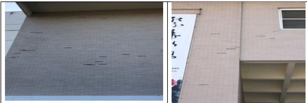
岡山文化中心行政棟北、西二面外牆時有磁磚脫落，具有安全之虞，亦造成外觀觀瞻不佳，磁磚脫落處更形成外牆雨水滲入入口。
