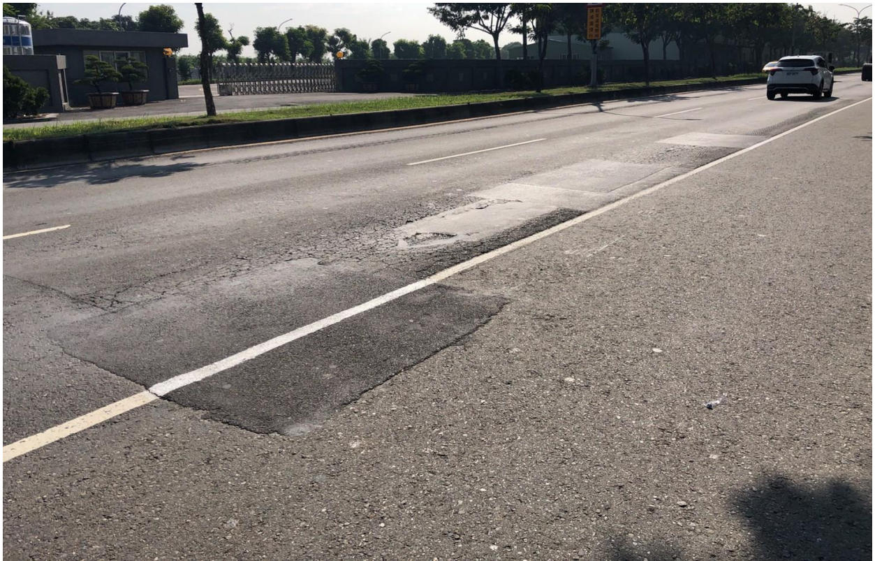
圖 4.1 現況照片 (補錠、裂縫)
