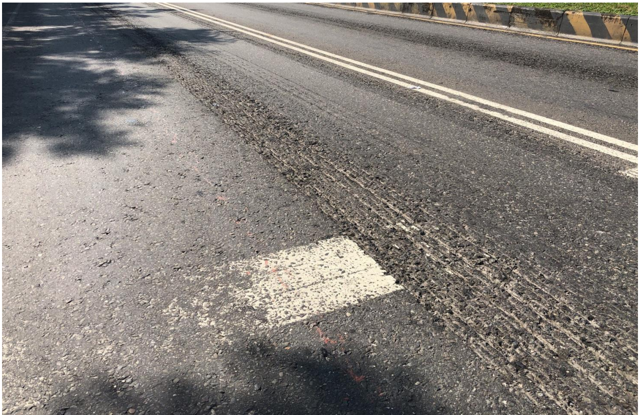
圖 4.2 現況照片 (車轍、面層磨損)
