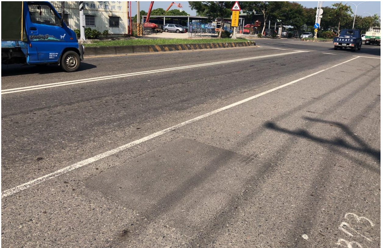
圖 4.4 現況照片 (車轍、補錠)
