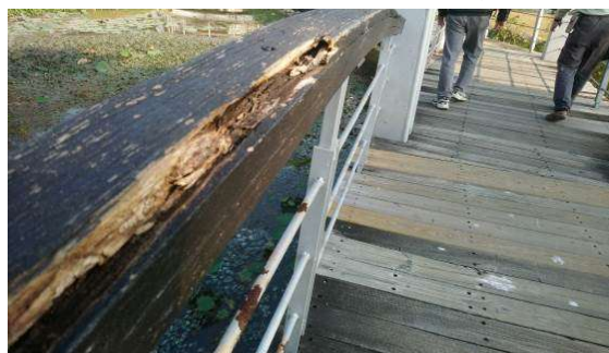
現有欄杆腐朽鏽蝕情況
