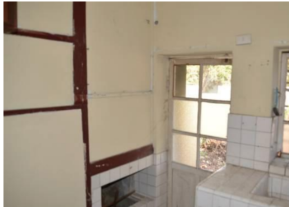
照片 6 台所木柱腐朽嚴重
