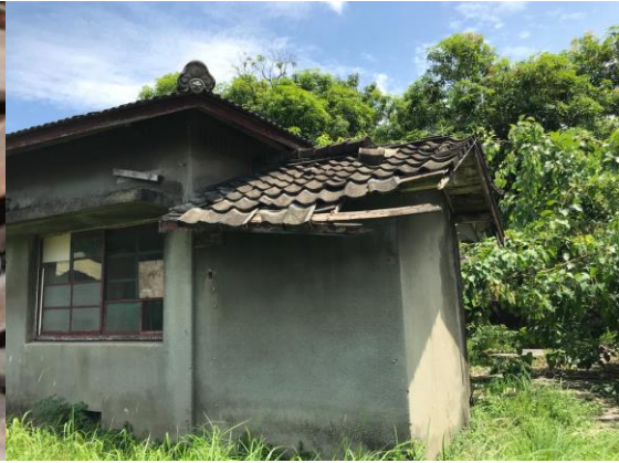
照片 10 屋面瓦作損壞
