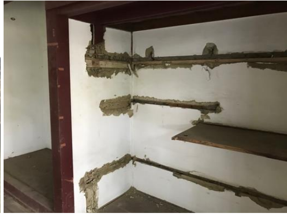
照片 4 床脇層板遭移除、編竹夾泥牆破損
