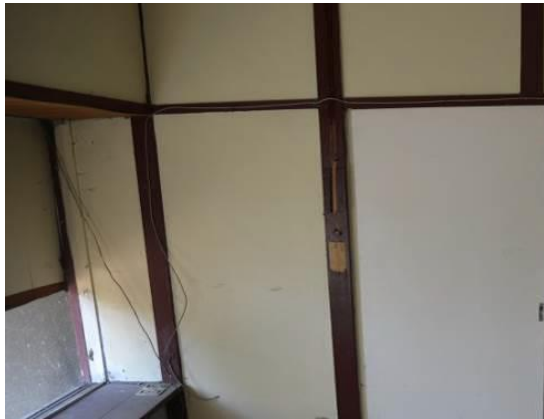
照片 5 座敷木柱劈裂
