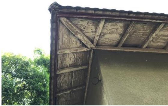
照片 3 外牆頂部粉刷層龜裂與剝落
