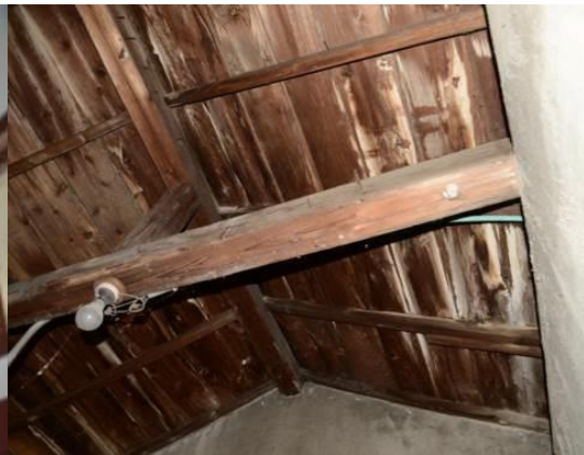
照片 8 倉庫屋面板滲水腐朽嚴重
