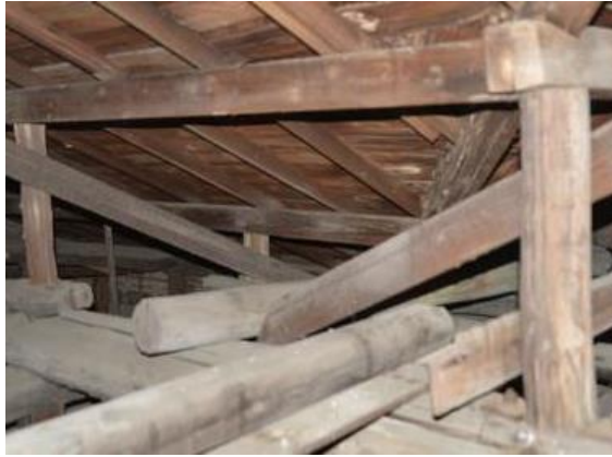
照片 9 屋架與屋面板腐朽
