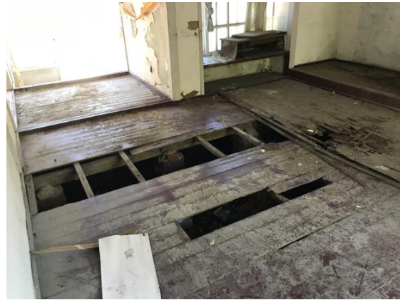
照片 2 木地板破損(9號)
