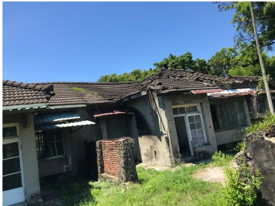
照片 7 屋組變形塌陷 (9 號)
