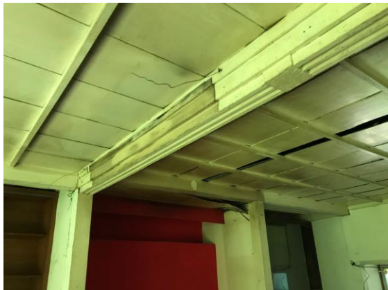
照片 9 軸組構件佚失 (10 號)
