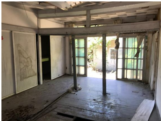
照片 3 軸組沉陷(9號)
