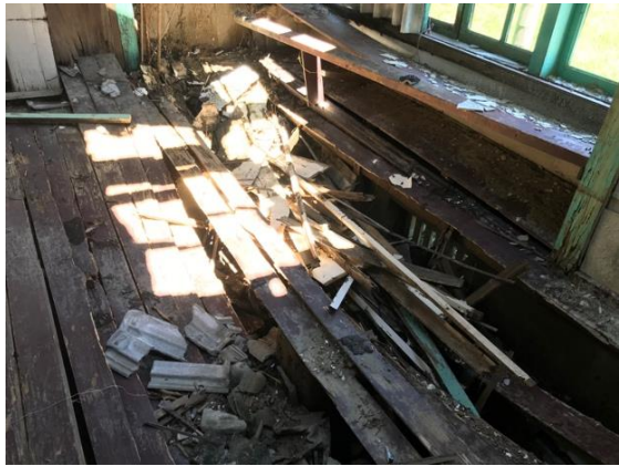
照片 1 床組沈陷(9號)
