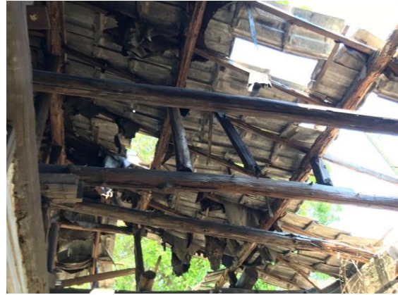
照片 6 屋組破損塌陷 (9 號)
