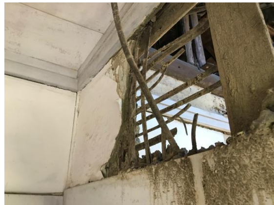
照片 4 編竹夾泥牆破損(9號)
