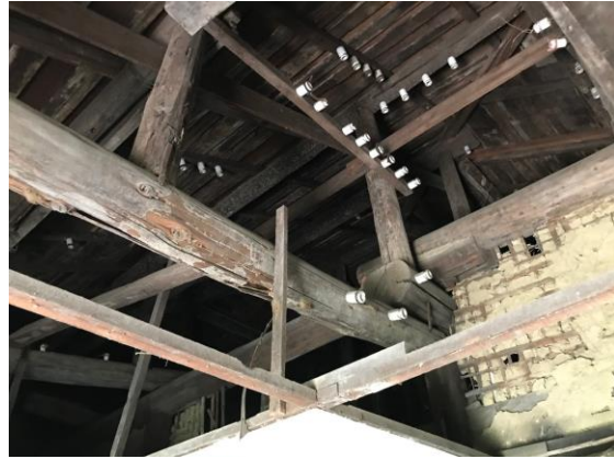
照片 12 屋架腐朽（10 號）
