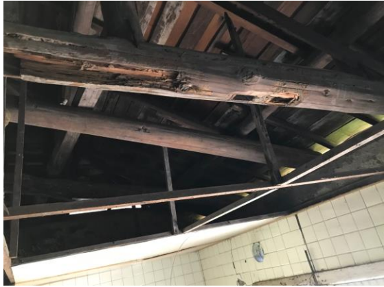
照片 11 屋架腐朽軸組構件佚失（10 號）
