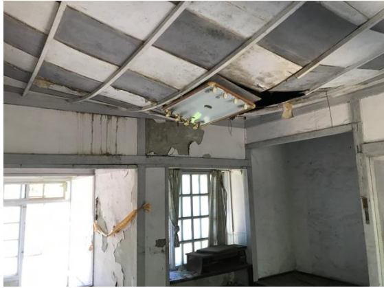
照片 5 天花板塌陷 (9 號)
