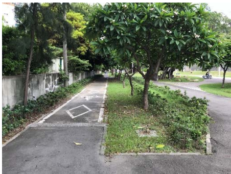
⑪ 新光碼頭段自行車道為 AC 鋪面，部分鋪面破損需重新鋪設。
