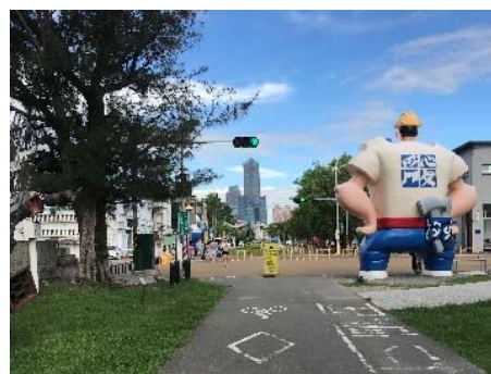
⑥ 路口自行車標線圖樣被新鋪設之鋪面蓋住，需補標示。
