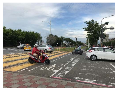
⑮鎮興路與凱旋四路交叉口應增設自行車號誌·確保民眾通行安全·並且地面標線脫落應補強。
