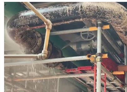
異丙苯洩漏處
