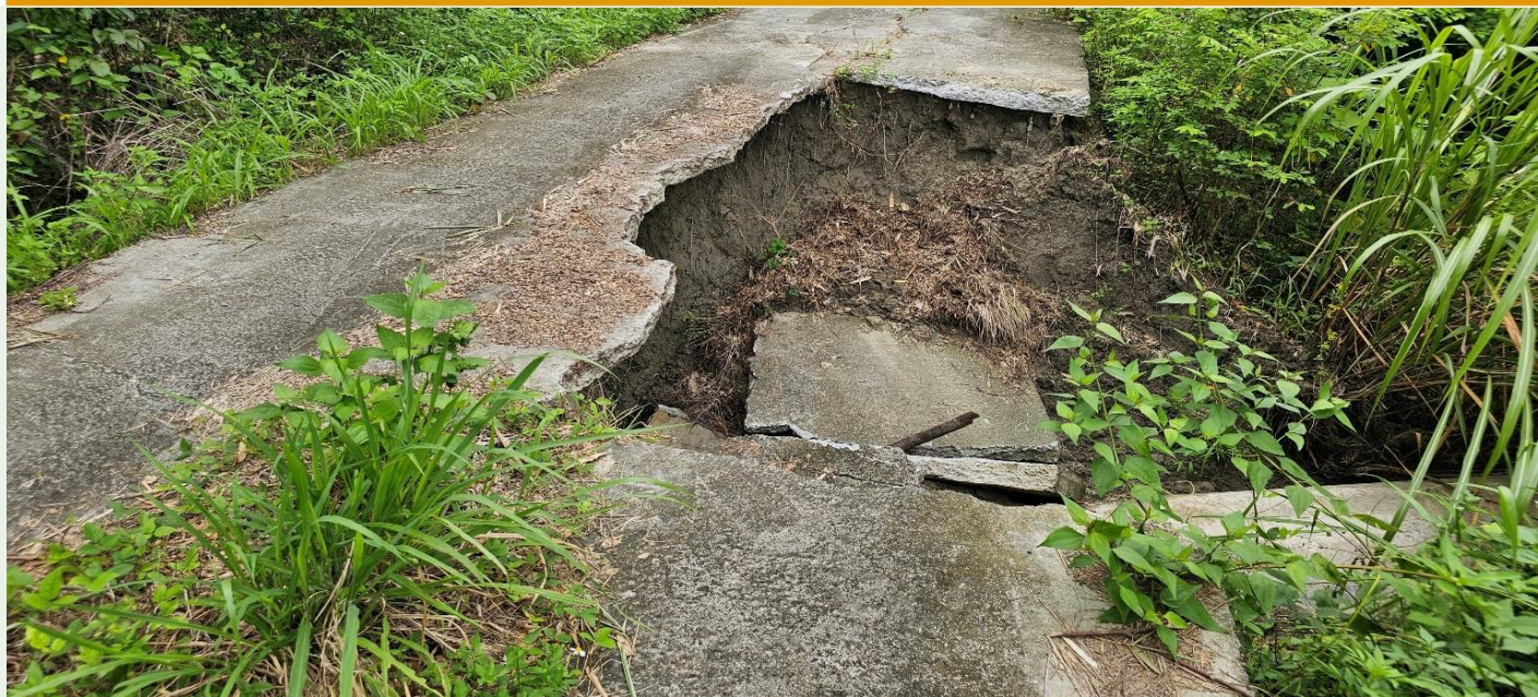
田寮區崇德里暖哮溝旁道路塌陷災後復建工程
