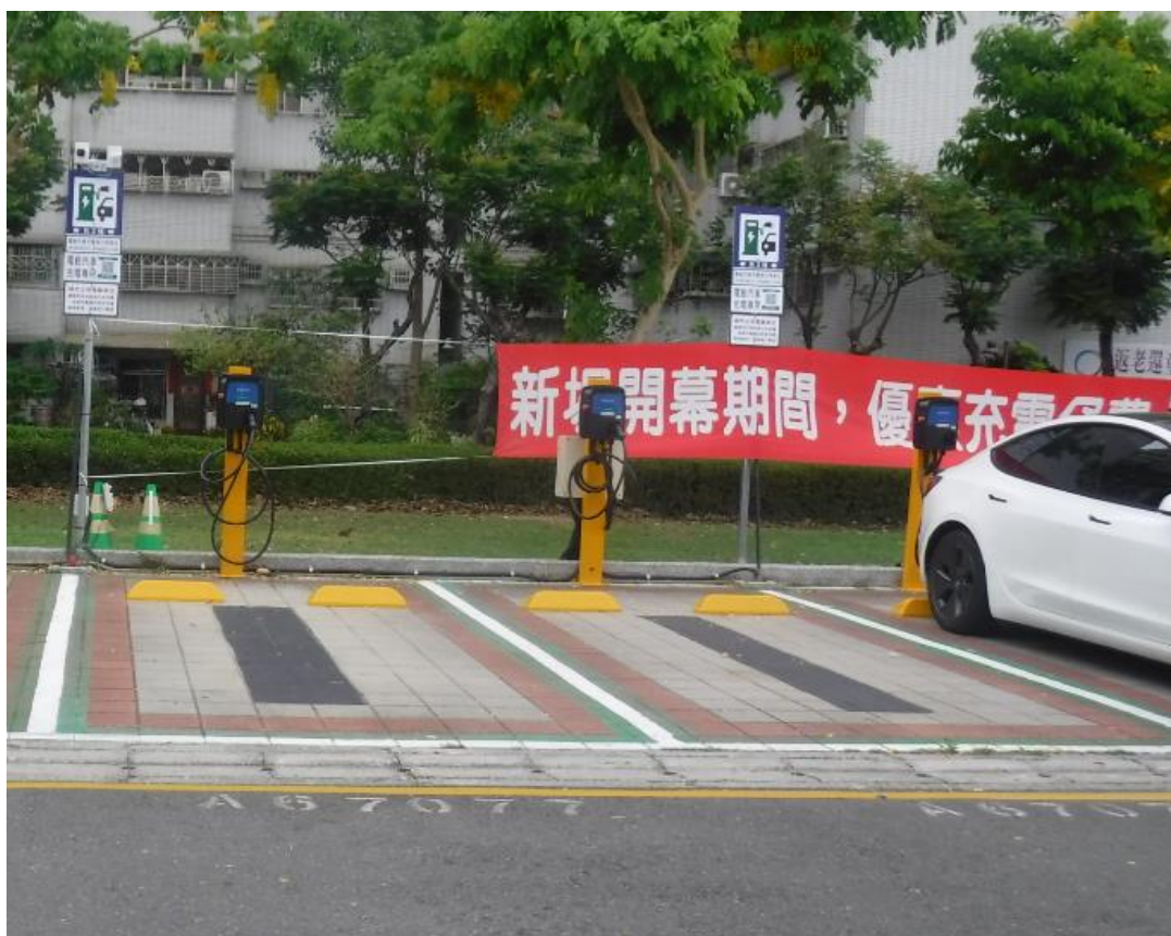
圖 19 電動車充電設備
