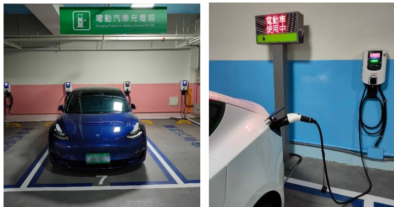
圖 13 電動車充電設備
