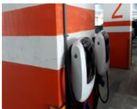
圖 27 電動汽車充電設備
