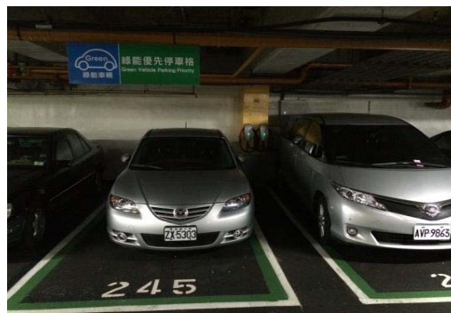
圖 22 場內電動車充電柱
