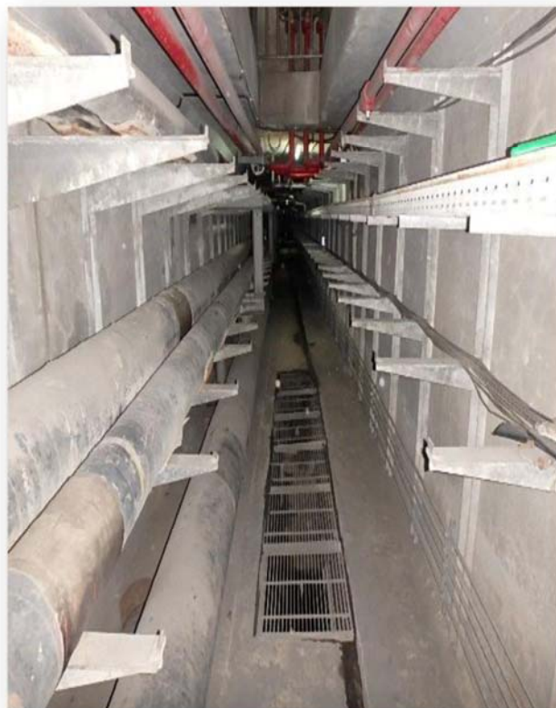
民族路共同管道內部空間情形
