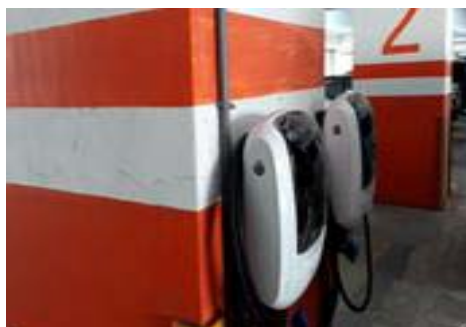
圖 27 電動汽車充電設備
