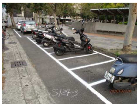
圖 68 小港區明鳳十街新設機車停車位
