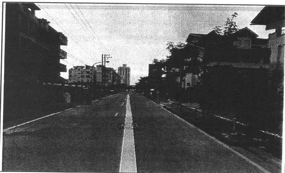
施工項目：濱湖路-路面 AC 凹凸未平整 日期：
