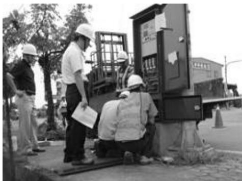
號誌控制器更新汰換
