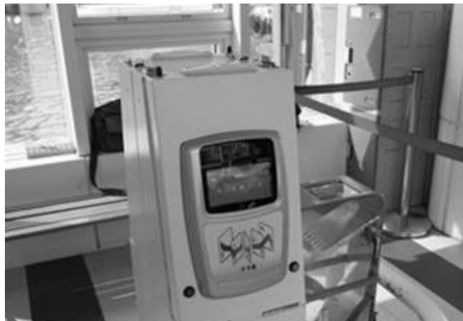
輪渡站多卡通票證設備
