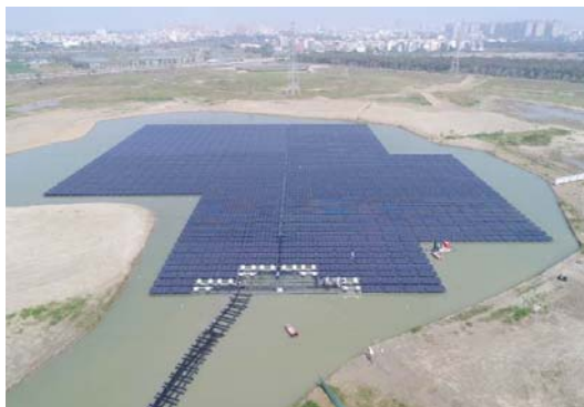
典寶溪 B 區滯洪池浮力式太陽光電
