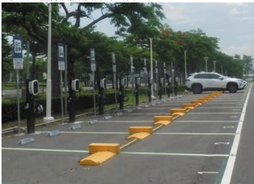
圖 25 電動車充電設備
