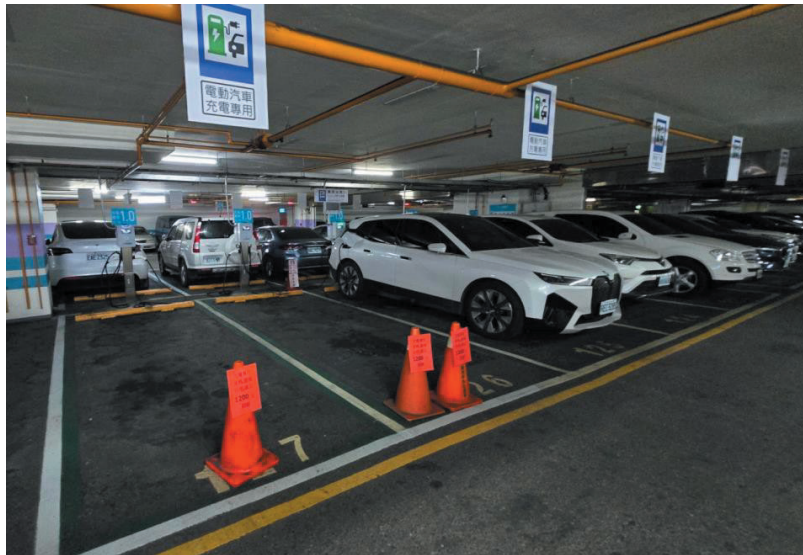
圖 25 電動車充電設備
