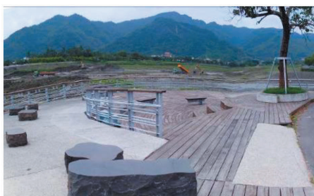
東側既有平台木板老舊待改善
