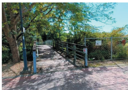
園區木棧橋木板老舊待改善(二)
