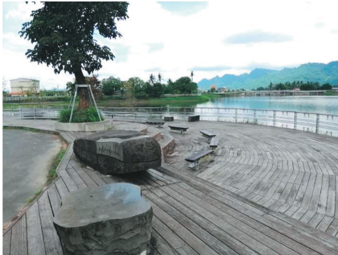
東側既有平台木板老舊待改善
