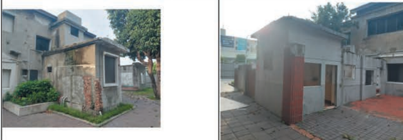
附屬建物遮蔽建物外觀，且作為公共廁所使用效能不彰，且高低落差影響行動不便者
