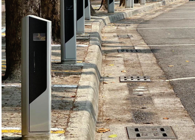
圖 17 車柱型車牌辨識系統
