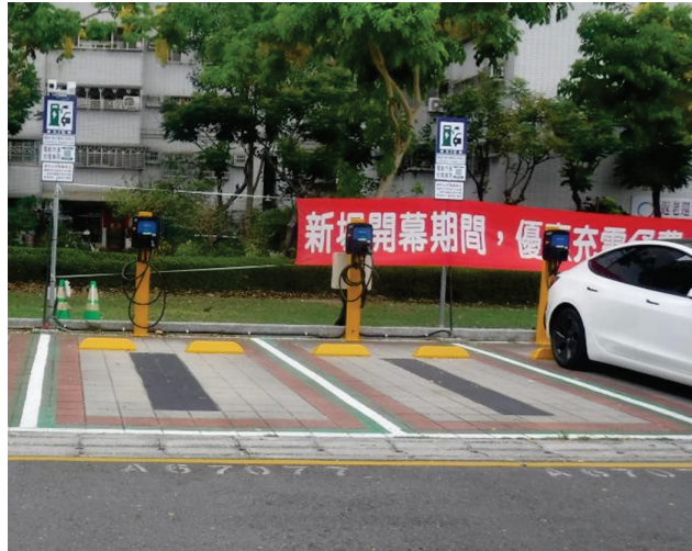
圖 19 電動車充電設備
