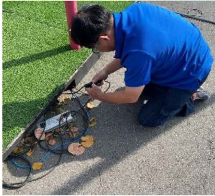
《巨人的夢幻花園》線路燒毀更換
