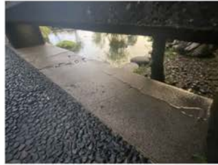
入口橋面邊沿龜裂需修復及強化橋面安全維護
