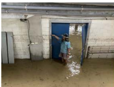
雙開門損壞需更新及提升抗災韌性
