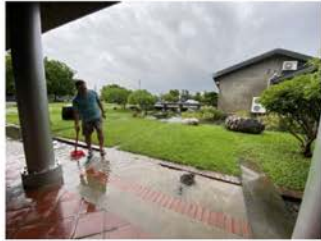
館舍周邊碎石區溢淹至廊道需清淤館區排水溝及強化排水設施
