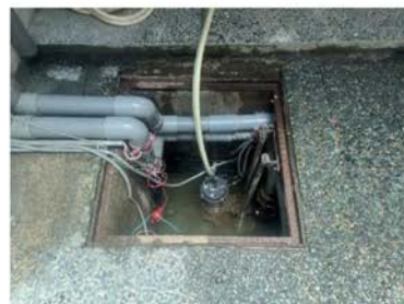
抽水機損壞需檢修及及提升抗災韌性
