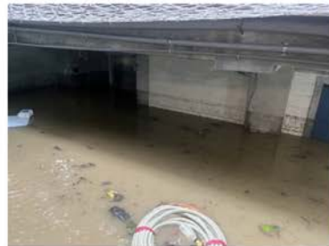
電梯損壞需檢修及提升抗災韌性
