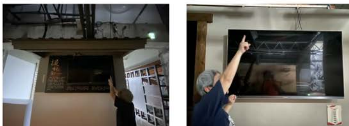
主題館二、三樓平面電視因受潮致功能受損，需檢修更新
