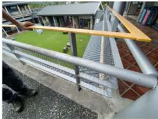
館舍護欄高度未達安全標準及受連日大雨沖刷致固定地面、牆柱有鬆脫或裂損，需全檢修更新
