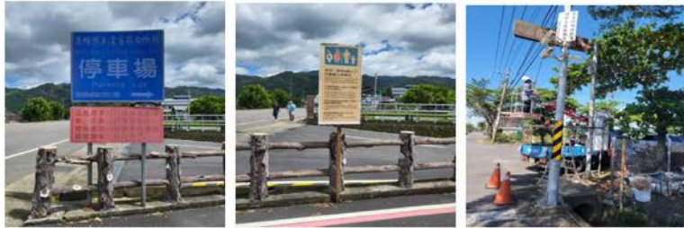
停車場及路口指標牌歪斜、鬆脫、支架斷裂須更新
