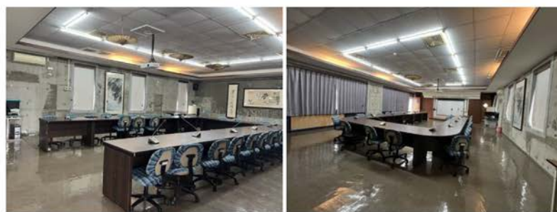
2樓簡報室天花板、窗戶及牆面多處漏水，規劃防漏工程及室內裝修工程，以強化會議室功能及建物抗災韌性
