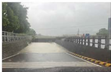
電動捲門毀損需更新及提升抗災韌性
