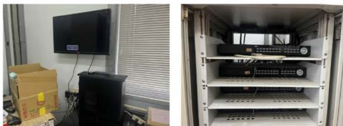
館區監視系統設備因強風及受潮致功能受損，需檢修更新
