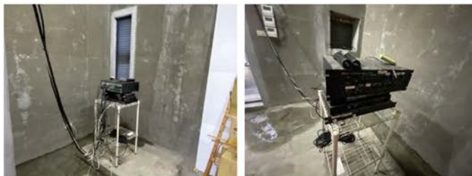
1樓特展室儲藏室音響因受潮致功能受損，需檢修更新
