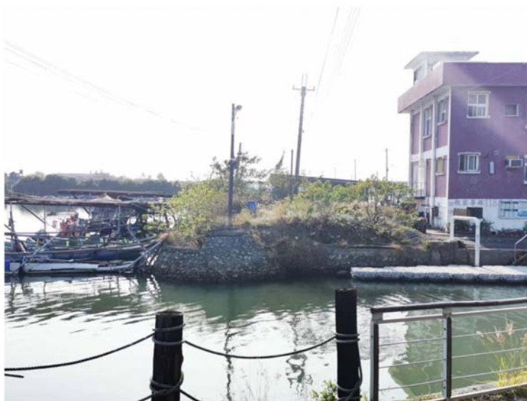
圖3 護岸老舊崩塌現況(港嘴周邊)
