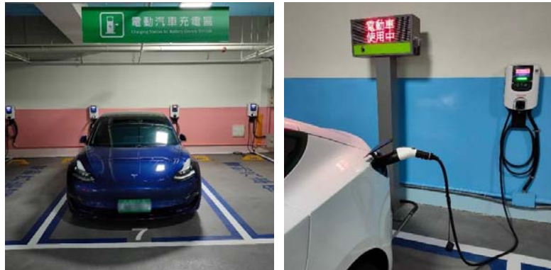
圖 13 電動車充電設備
