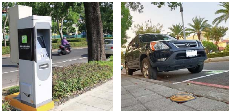
圖 12 繳費機及智慧停車設備
