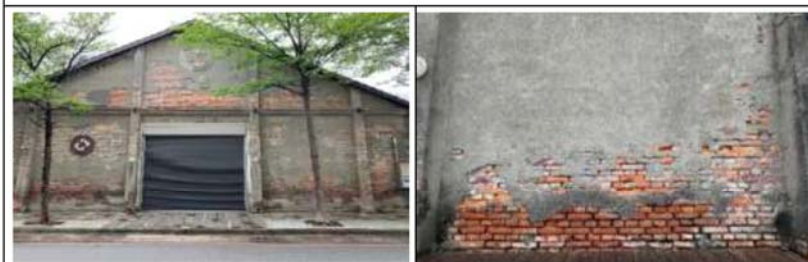
大勇區倉庫磚造結構裸露且大面積剝落之現狀
