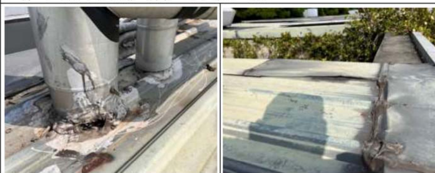
大義區屋頂防水浪板鏽蝕損壞及防水層壁面剝落
