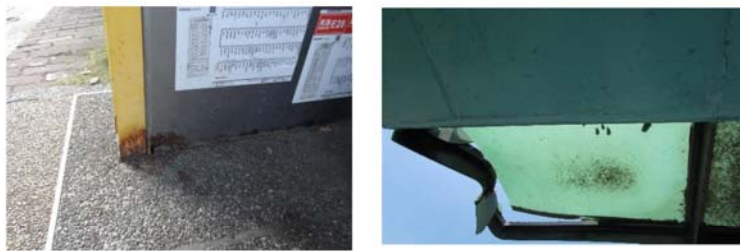
圖一 高雄市既有候車亭老舊現況
