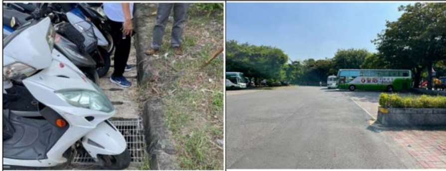
北側停車場周邊排水不佳，下雨容易積水造成遊覽車遊客上下車不便，部分停車空間及遊客步行空間不友善
