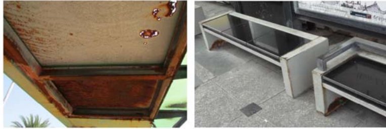
圖一 高雄市既有候車亭老舊現況
