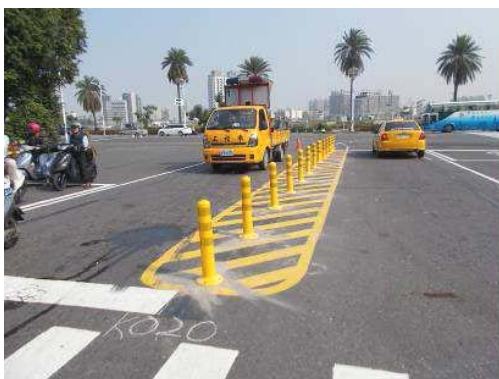
圖 48 前鎮區中山四路與鎮海路分隔桿
