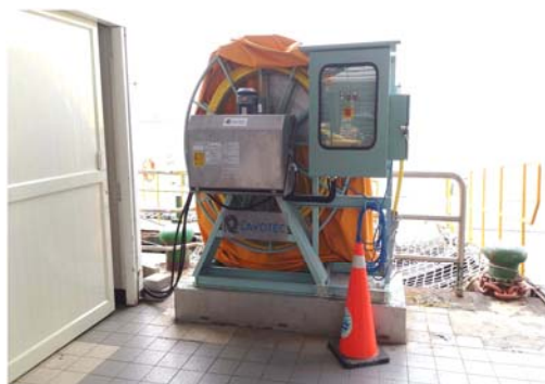
圖 60 旗津端岸上快速充電設備
