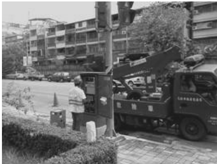
號誌控制器檢修
