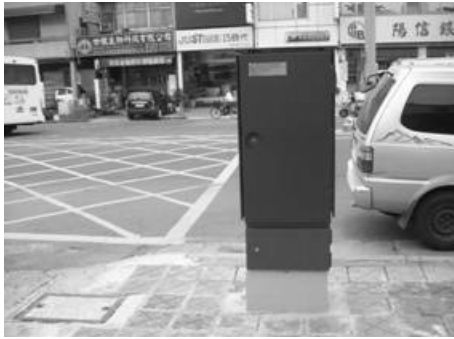
鼎力路公車站新設號誌控制器
