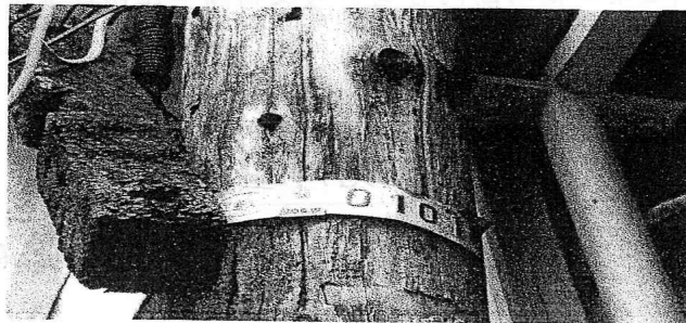
圖上電線桿年久失修已傾斜
