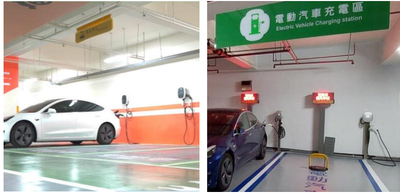
圖 13 電動車充電設備
