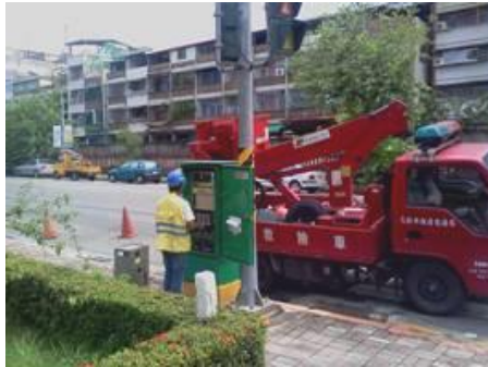
號誌控制器檢修
