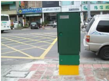
鼎力路公車站新設號誌控制器
