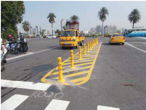
圖 48 前鎮區中山四路與鎮海路分隔桿
