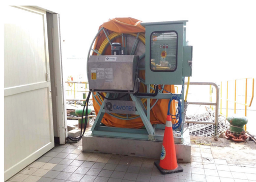
圖 60 旗津端岸上快速充電設備
