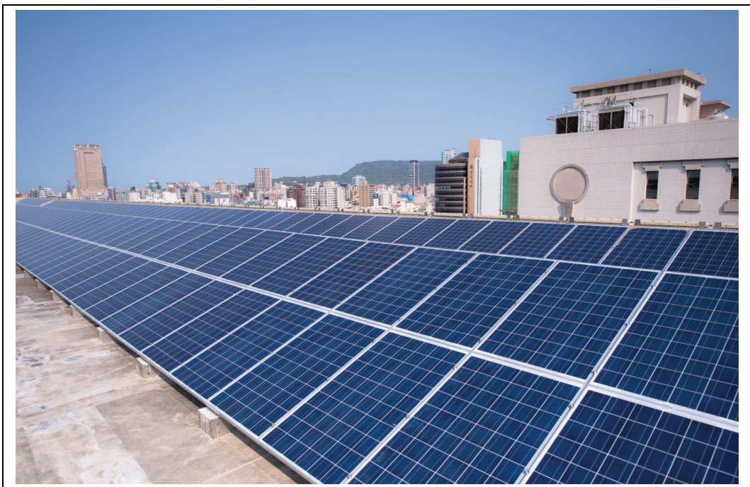
照片 20：四維行政中心 11 樓露台設置太陽光電發電系統
