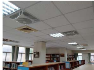
大社分館安裝循環扇，讓空間更為舒適與通風。
